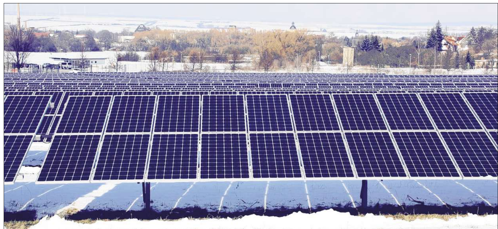
Sauberer Strom für rund 1500 Haushalte: Das von den Stadtwerken Heidenheim übernommene Solarfeld bei Greußen in Thüringen. Foto: pm
